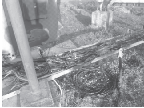
आगजनीबाट क्षतिग्रस्त भएको एनसेल टावर
